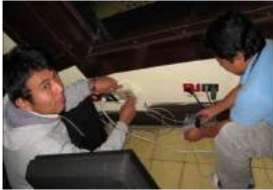
Intalación, control y revisión de puntos de red.
