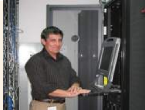
Intalaciones de Data Center.
